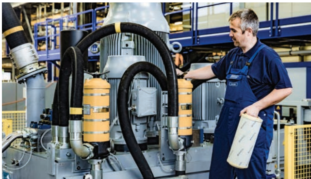
Rechtzeitig eingreifen: Dank FEINmonitoring wird der Ölfilter einer Presse rechtzeitig ausgetauscht, ungeplante Stillstände werden vermieden.
